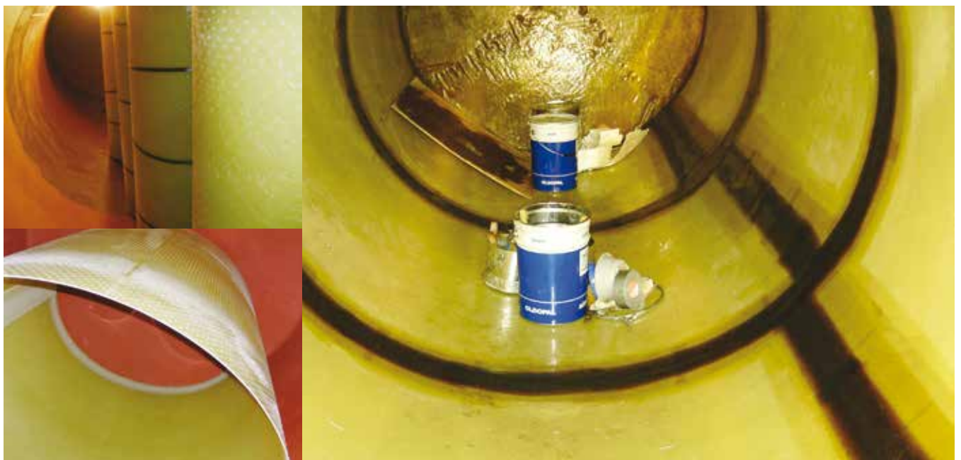
Abb.: Doppelwandige GFK-Auskleidung eines Stahltanks mit 25.000 Liter Volumen für die sichere Lagerung von Essigsäure
